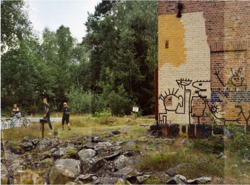
Bemalungen am Transformator
